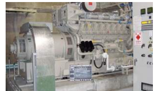
災害時などに重要な役割を果たす非常用発電機
